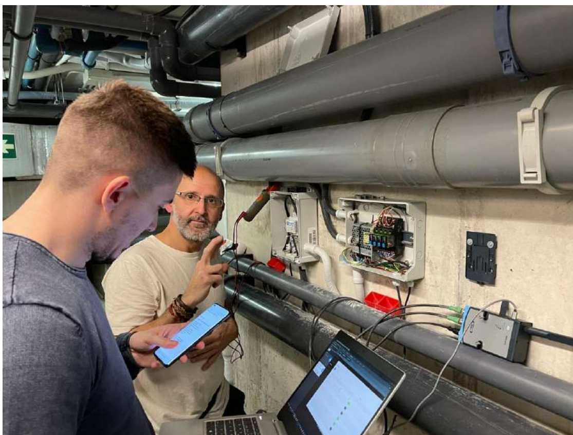
Proyecto de Aguas de Valencia con sensores conectados a una red LoRaWAN.
